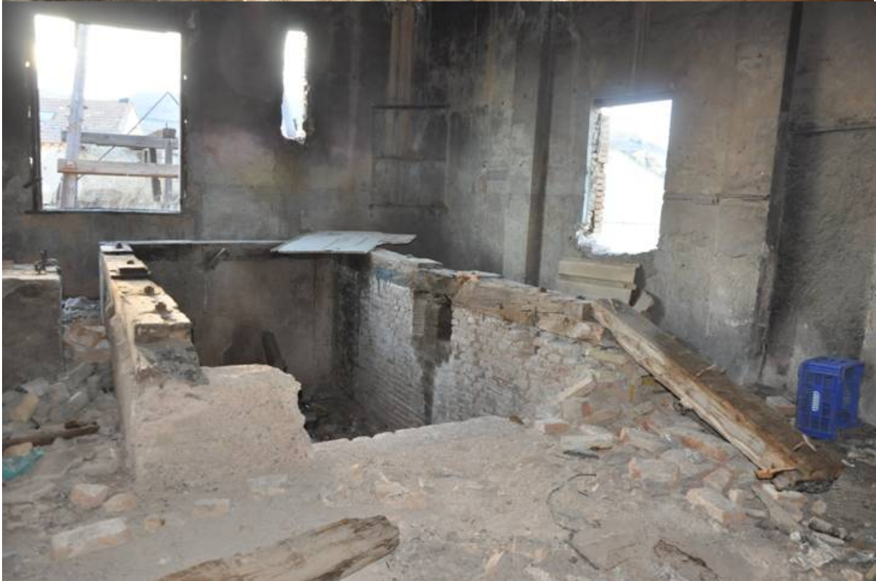
Ilustración 2. Interior de la Mina Lo Veremos Viejo, antes y después del expolio de su maquinaria.
